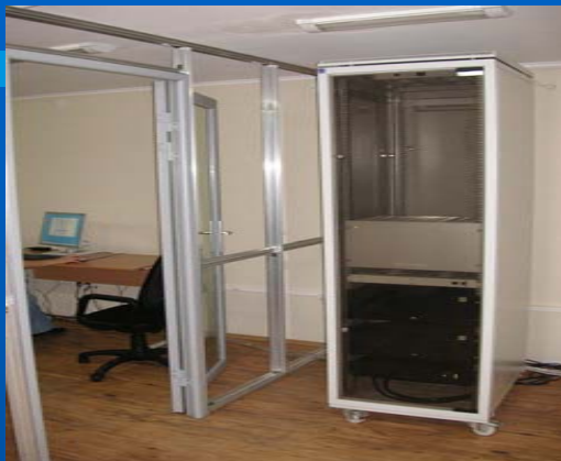
Стойка с приемной аппаратурой
